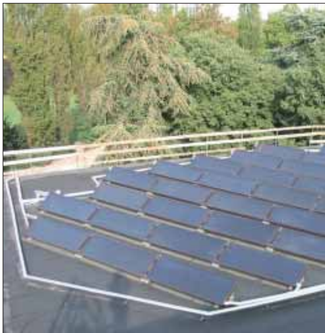
Pannelli solari sul tetto della piscina Dogali. Sotto: le ex Fonderie di Modena
