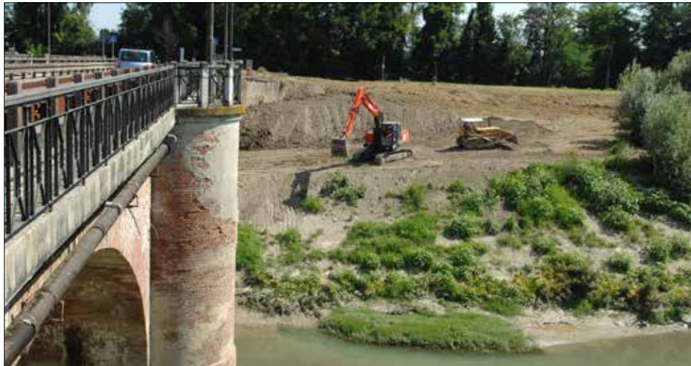
Lavori di consolidamento argini a Ponte Alto. Sotto, cassa d'espansione del fiume Secchia
