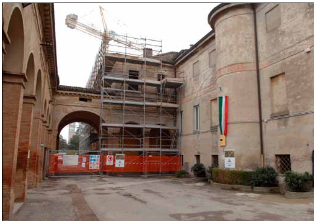
Il cantiere aperto nel cimitero di san Cataldo per realizzare l'impianto di cremazione
