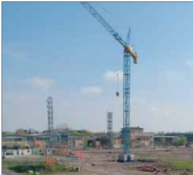
Edifici in costruzione nella zona della fascia ferroviaria, dove il Comune sta verificando la possibilità di realizzare un impianto di riscaldamento utilizzando l'energia dell'inceneritore
