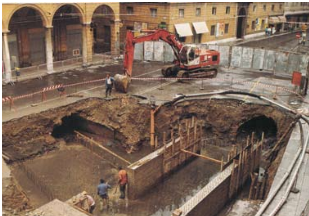
Figura 17 - Rifacimento della rete fognaria nel centro storico, con la sostituzione di manufatti moderni alla rete dei canali storici coperti, ancora ben visibili nella foto. (da La città che non si vede. Modena e l'acqua: sistema idraulico e fognario , a cura di Giovanni Bartoli, Comune di Modena, 2003)
