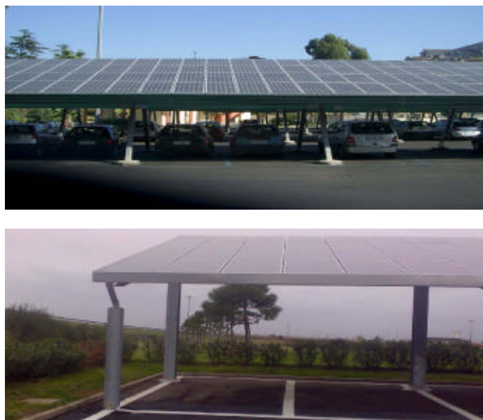
Fig. 9 - Esempi di installazioni fotovoltaiche su pensiline
