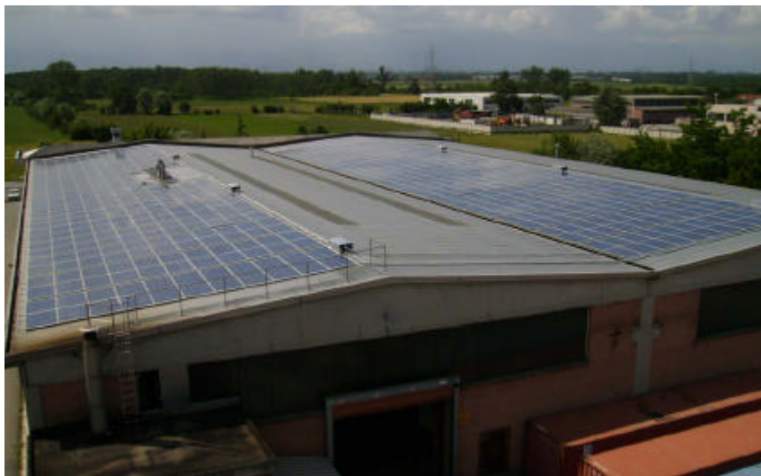
Figura 6 - Esempio di installazione fotovoltaica su capannone
